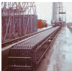
5 Catene 35 dotate di carro mobile applicate su impianto di De Icing presso l'aeroporto di Monaco di Baviera D. Lunghezza corsa m. 90 Velocità di scorrimento m 90 al minuto.
