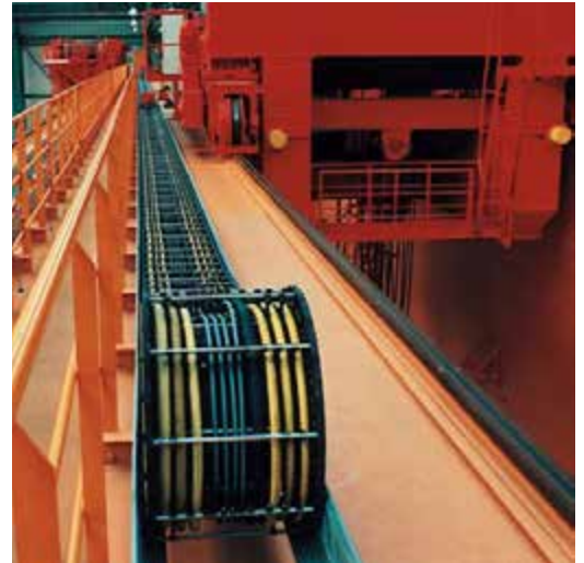
Chaîne type 318 pour longues courses, installée sur un pont roulant.
