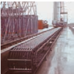
Chaînes 35NT dotées d'un chariot mobile appliquées à une installation de De Icing, à l'aéroport de Munich, en Allemagne. Longueur de la course 90 m. Vitesse de déplacement 90 m/minute.
